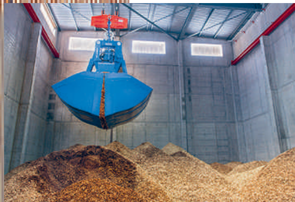
Silo mit Holzschnittel
